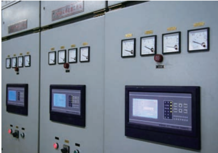
神東電力店塔電廠改造後的除塵器高壓控制櫃
