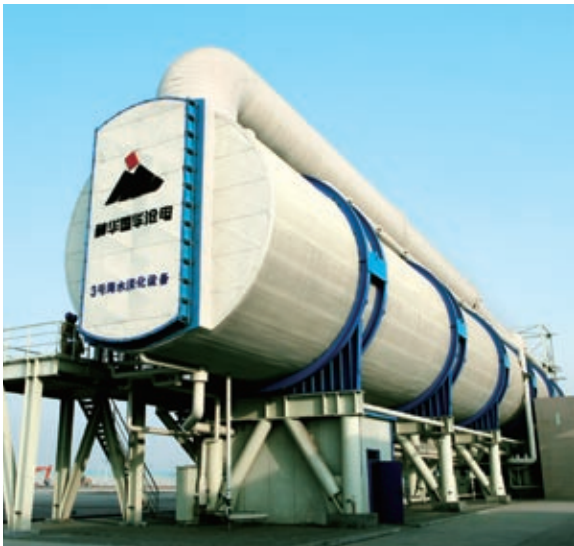
黄骅电厂海水淡化装置
