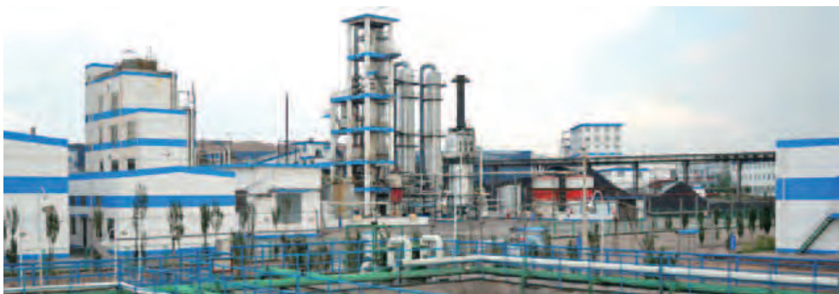
包头煤化工污水处理系统
