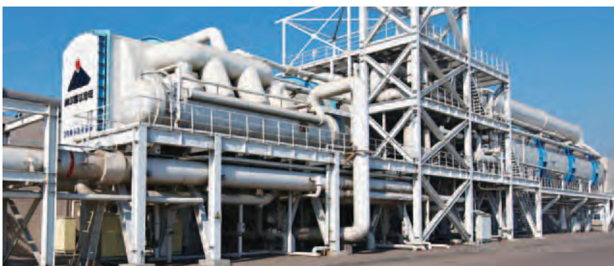
沧东电厂海水淡化设备
